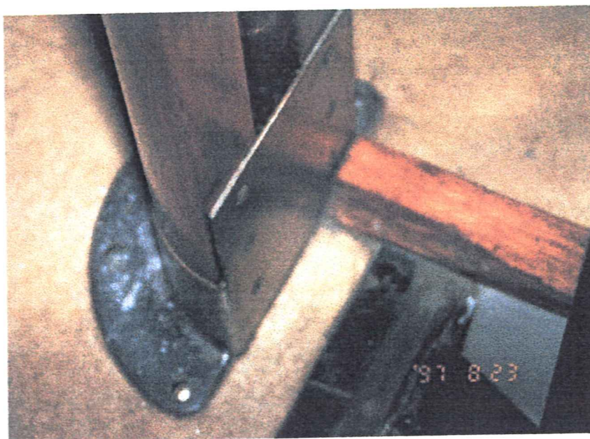
Beslag på rekkverkstøtte / megler.
